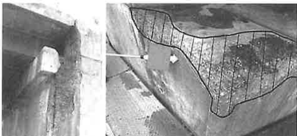
写真-3 凍結抑制剤を含む水によりスケーリング劣化した橋台
